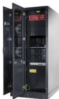
BANCA data center ambiente server
