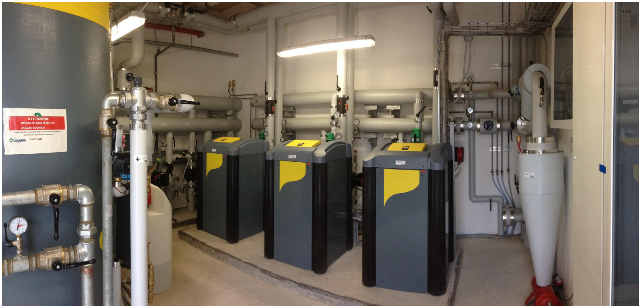
Centrale geotermica potenza erogata 140 kW termici
