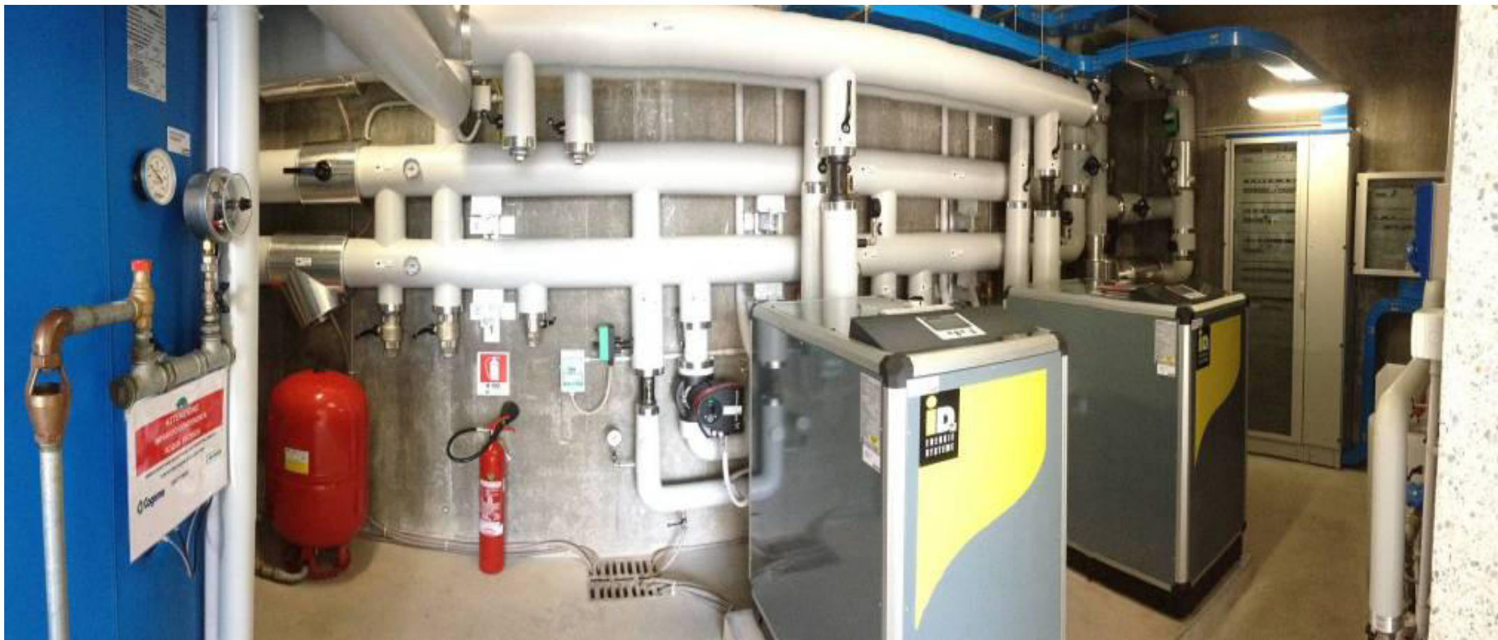
Centrale geotermica potenza erogata 100 kW termici
